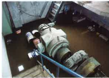
臼井第二機場内浸水
